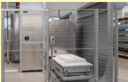
Zone de sécurité délimitée par des portes roulantes et une barrière de protection
