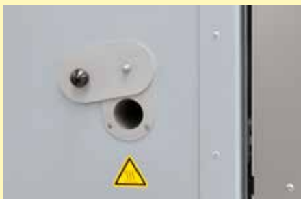
Passaggio per termocoppia
