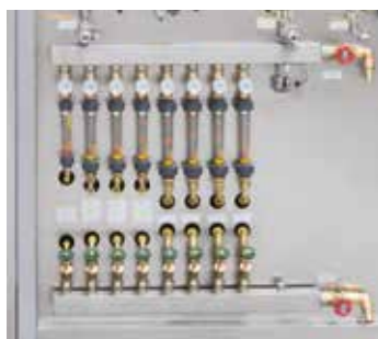
Distribuzione acqua di raffreddamento
