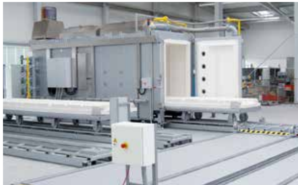
コンビネーション炉設備、ガス加熱ハースワゴン炉WB11000/HSとハースワゴン移送システムおよび補助ハースワゴン2台(待避レールも含む)から成る。
