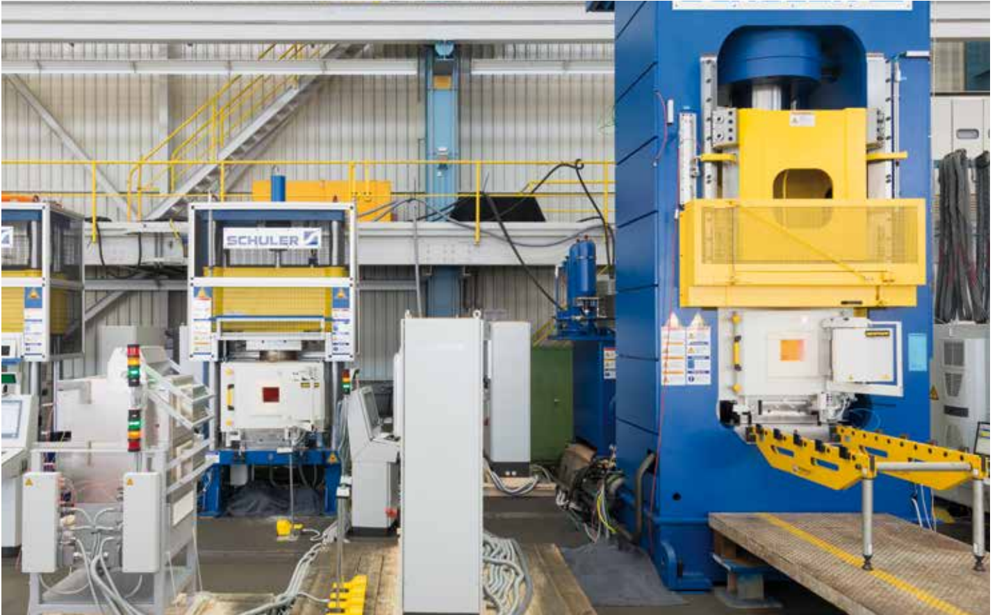
加熱変形装置におけるプレスラム加熱用予熱炉
