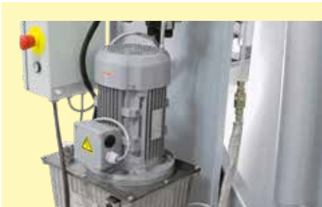
Hydraulik-Aggregat mit schwer brennbarer Hydraulikflüssigkeit
