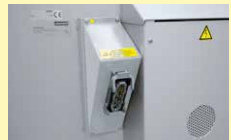
Steckvorrichtung am Ofen für den Kabelanschluss an die Schalt- und Regelanlage
