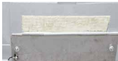
Tiegelbruchmeldung unterhalb des Notauslaufs eines Schmelzofens
