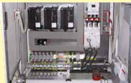
Schaltanlage mit Thyristoren im Phasenanschnittbetrieb für ökonomische Leistungsregelung
