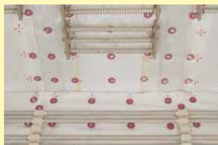
Gewebetuchabdeckung der Faserdecke (und Seiten) zur Reduzierung von Faserstäuben
