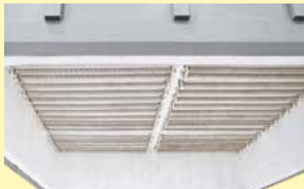
Heizelemente in der Ofenhaube
