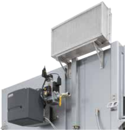
Direkte Gasbeheizung an einem Kammertrockner
